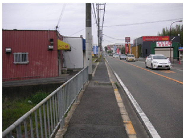
歩道中央グレーチング、古い舗装、表面凹凸
