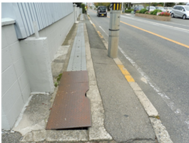
グレーチングの先に鉄板
