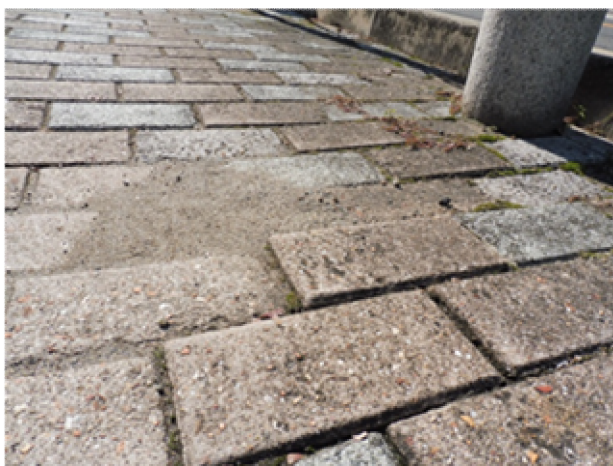
へこみ+砂（ずれ）段差
