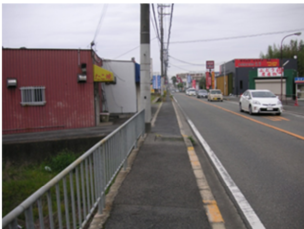
歩道中央グレーディング、古い舗装、表面凹凸
