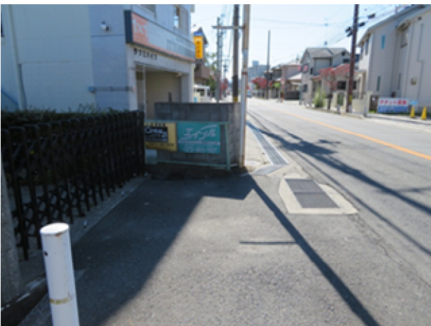
途中で途切れている歩道
